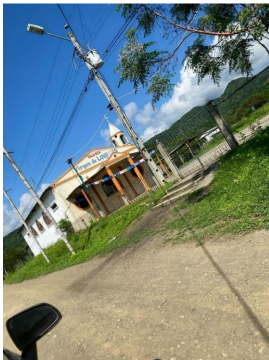
Figura 6.2. Red eléctrica aérea en el centro poblado de Joa
