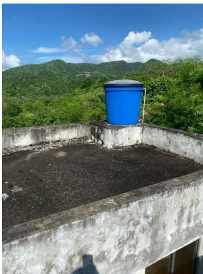
Figura 4.5. Tanque domiciliario para almacenamiento de agua
